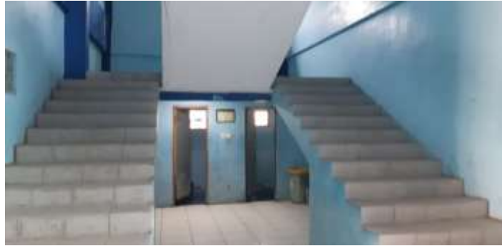
Gambar 4. Tangga Tanpa Railing (Pegangan)
