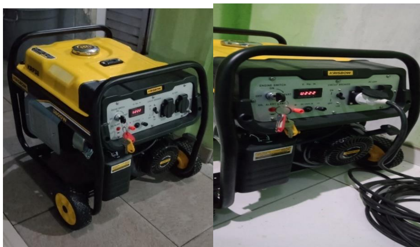
Gambar 5. Genset Dinyalakan Hingga Mengeluarkan Tegangan Normal 222 Volt
